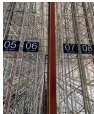
某项目堆垛机托盘库
