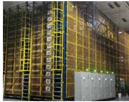
某项目模组输送调度缓存库
