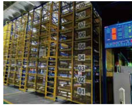
某项目模组输送调度缓存库
